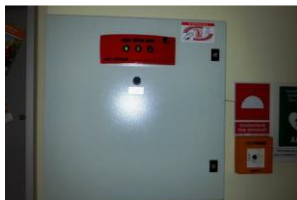
Centrala systemu sygnalizacji pożaru
