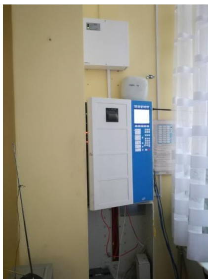
Centralka Systemu Sygnalizacji Pożaru
