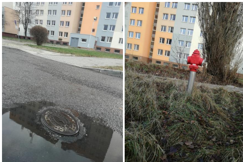
Hydrant zewnętrzny na wjeździe Hydrant zewnętrzny od strony zachodniej
