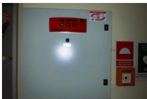
Centrala systemu sygnalizacji pożaru
