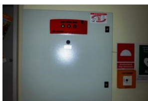
Centrala systemu sygnalizacji pożaru
